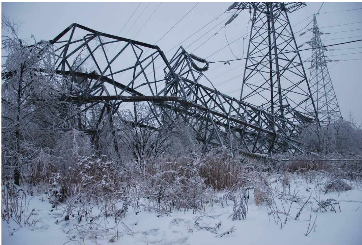
Рис. 10. Пример аварии на ЛЭП, вызванной климатическими условиями
