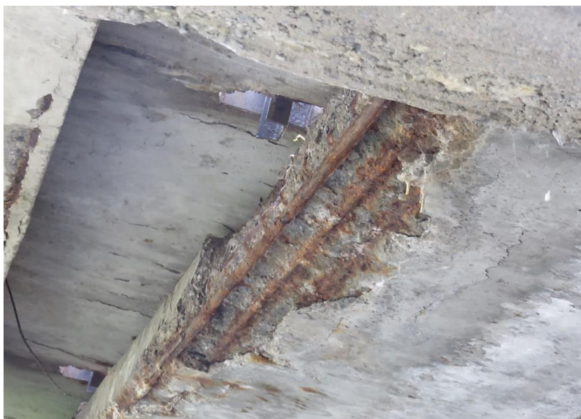
Рис. 1. Мост через ручей на км 43,915 автомобильной дороги Р-57: деструкция бетона, коррозия арматуры плиты из-за отвода воды через окно в тротуарном блоке.
