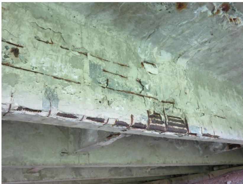
Рис. 6. Мост через р.Болвань на км 403,904 автомобильной дороги Р-43: деструкция бетона, коррозия арматуры балки.
