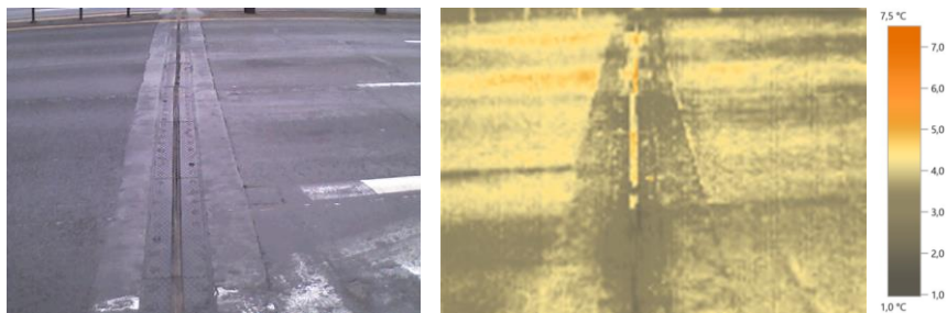
Рис. 4. Деформационный шов с плитными резинометаллическими элементами. Возраст шва 1 год.
