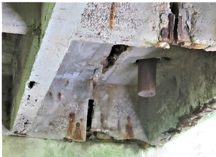
Рис. 5. Мост через р.Солянка на км 304,911 автомобильной дороги Р-43: разрушение бетона плиты и диафрагм балки, разрушение связей диафрагм балок пролетного строения.
