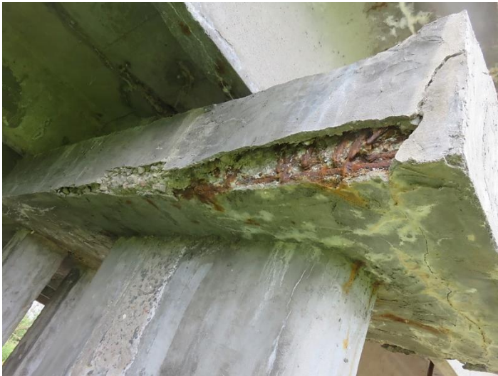
Рис. 3. Мост через р.Весея на км 342,538 автомобильной дороги Р-43: деструкция бетона, коррозия арматуры насадки опоры.
