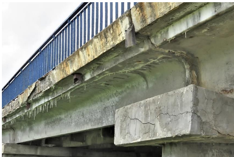
Рис. 4. Мост через р.Весея на км 342,538 автомобильной дороги Р-43: трещины с выщелачиванием бетона, stalактиты по плите фасадной балки, размораживание бетона борта монолитного тротуара.
