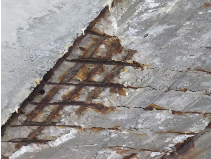
Рис. 2. Мост через ручей на км 43,915 автомобильной дороги Р-57: деструкция бетона, коррозия арматуры плиты.
