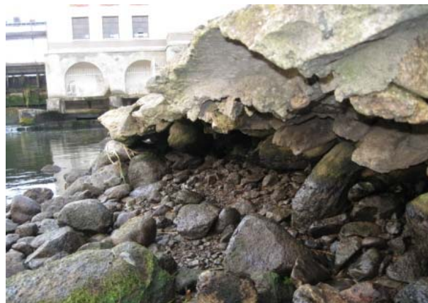
Рис. 1. Повреждение креплений в нижнем бьефе на водохранилище Волна
