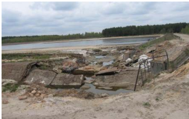
Рис. 5. Разрушение плотины на водохранилище Княжеборское (Млынокское)
