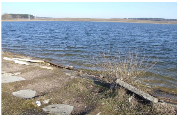
Рис. 6. Повреждения ГТС пруда-накопителя у города Смоленичи
