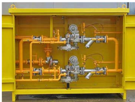
Рисунок 5.3.3 – Общий вид шкафа для регулирования газа (ГРП)
