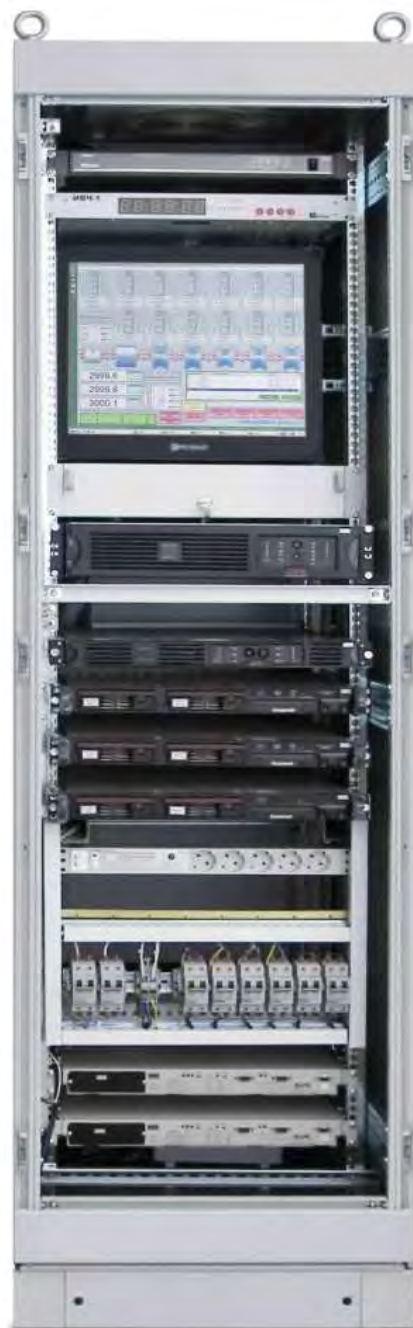
Рисунок 4.1 Шкаф с оборудованием системы ИТ14.
