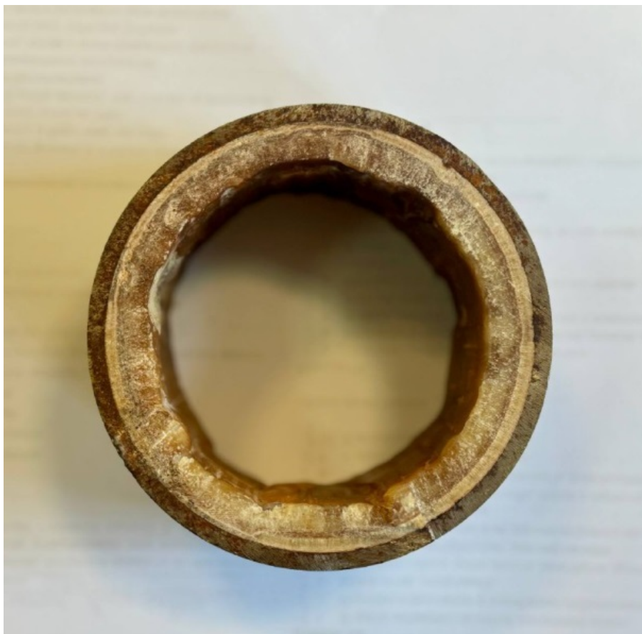
Рисунок 4 – Отложения в распределительном трубопроводе
