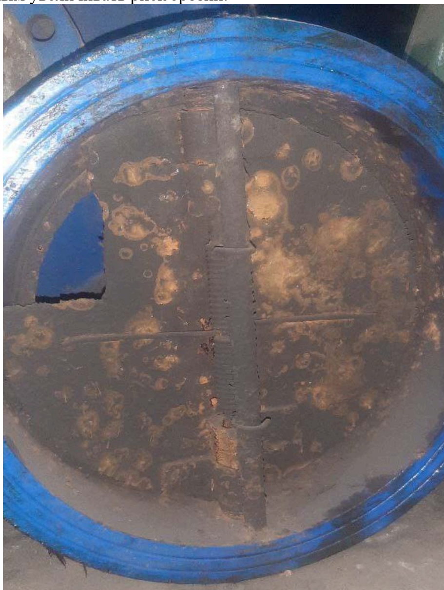
Рисунок 3 – Коррозия задвижки насоса
