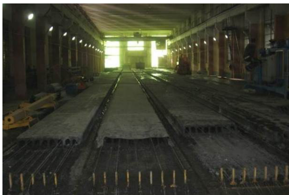
Рис. 2. Линия "Тенсиланд" для производства плит безопалубочного формования
