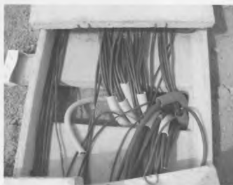
Рис. 4. Силовые и контрольные кабели проложены совместно без соблюдения защитного расстояния
