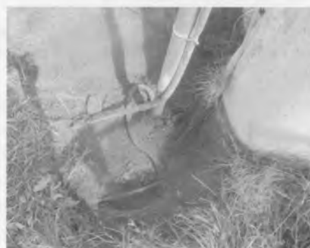
Рис. 5. Кабель питания освещения заведён на опору с молниеотводом без соблюдения защитных мер
