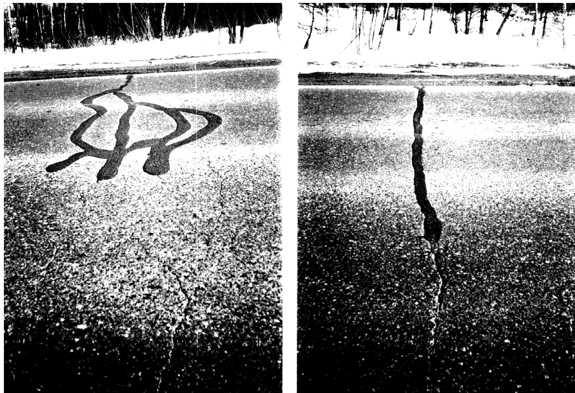
Рис. 2.42. Результаты заливки трещин
