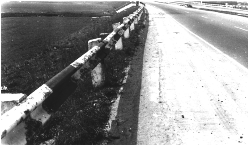
Рис. 1.26. Разрушение слоя краски на барьерном металлическом ограждении
