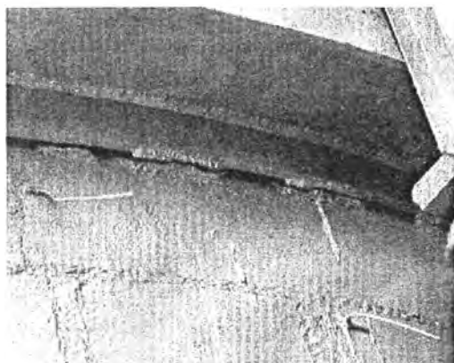
Рисунок 5.2 – Трещины в сварных швах крепления бандажного кольца к корпусу колонны
