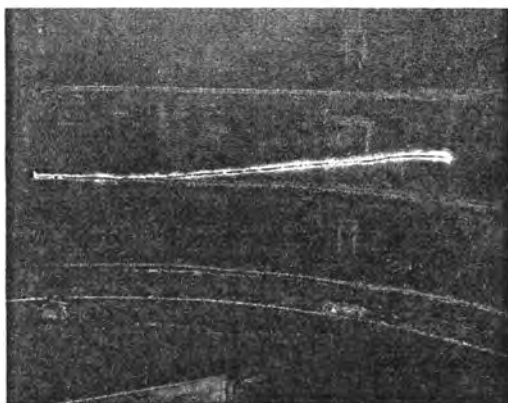
Рисунок 5.1 – Сквозная трещина корпуса колонны
