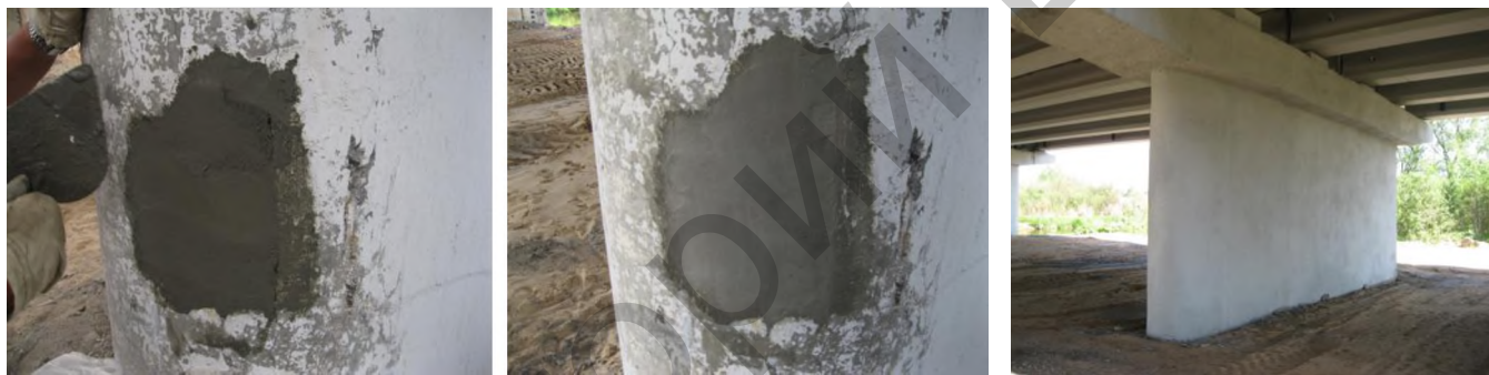
Рисунок. 6 –Защитный слой после восстановления, через 90 суток, и общий вид опоры через 14 месяцев
