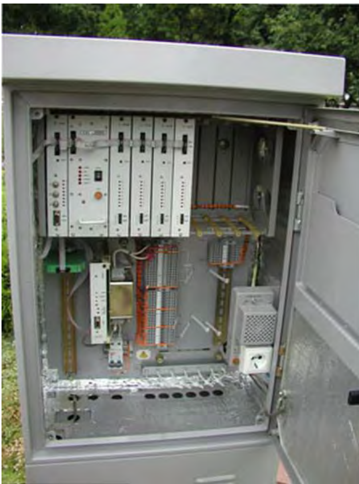
Рисунок 3.14 – Дорожный контроллер БДКЛ-М1
