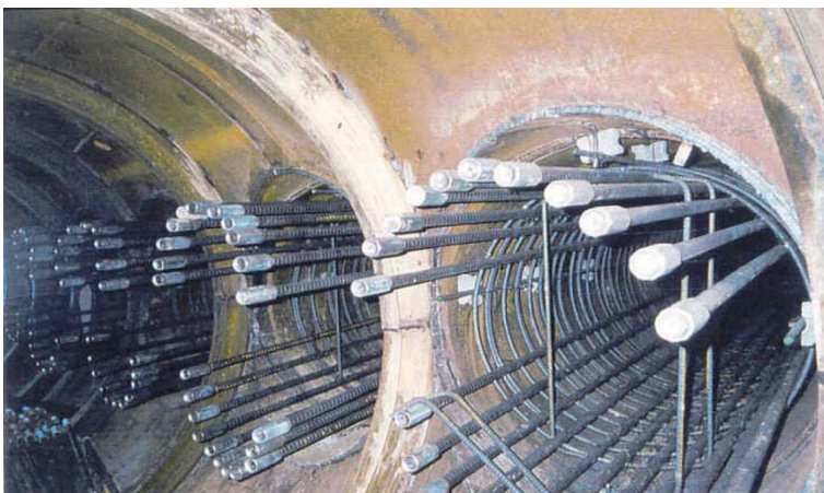
Рисунок 3 – Перекрытие поперечными ненапрягаемыми армированными трубами, выполненное опережением забоя из угловых труб перегонного тоннеля метрополитена. Сеул, Республика Корея [3]
