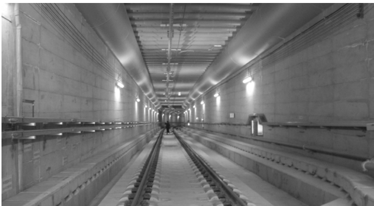
Рисунок 2 – Перегонный тоннель метрополитена Сеула с перекрытием поперечными армированными трубами, выполненное опережением забоя из угловых труб. Сеул, Республика Корея [4]
