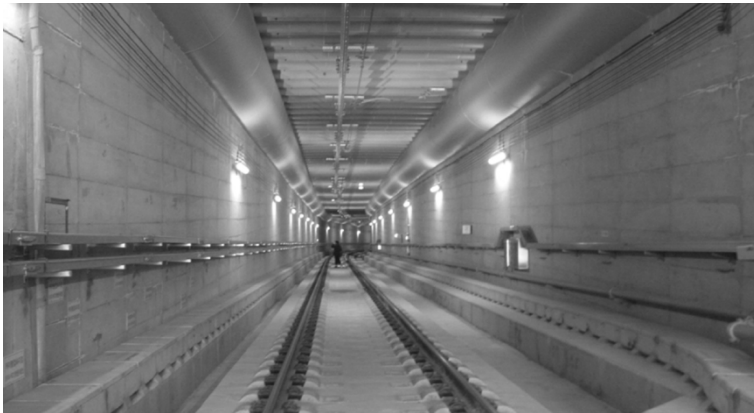
Рисунок 2 – Перегонный тоннель метрополитена Сеула с перекрытием поперечными армированными трубами, выполненное опережением забоя из угловых труб. Сеул, Республика Корея [4]
