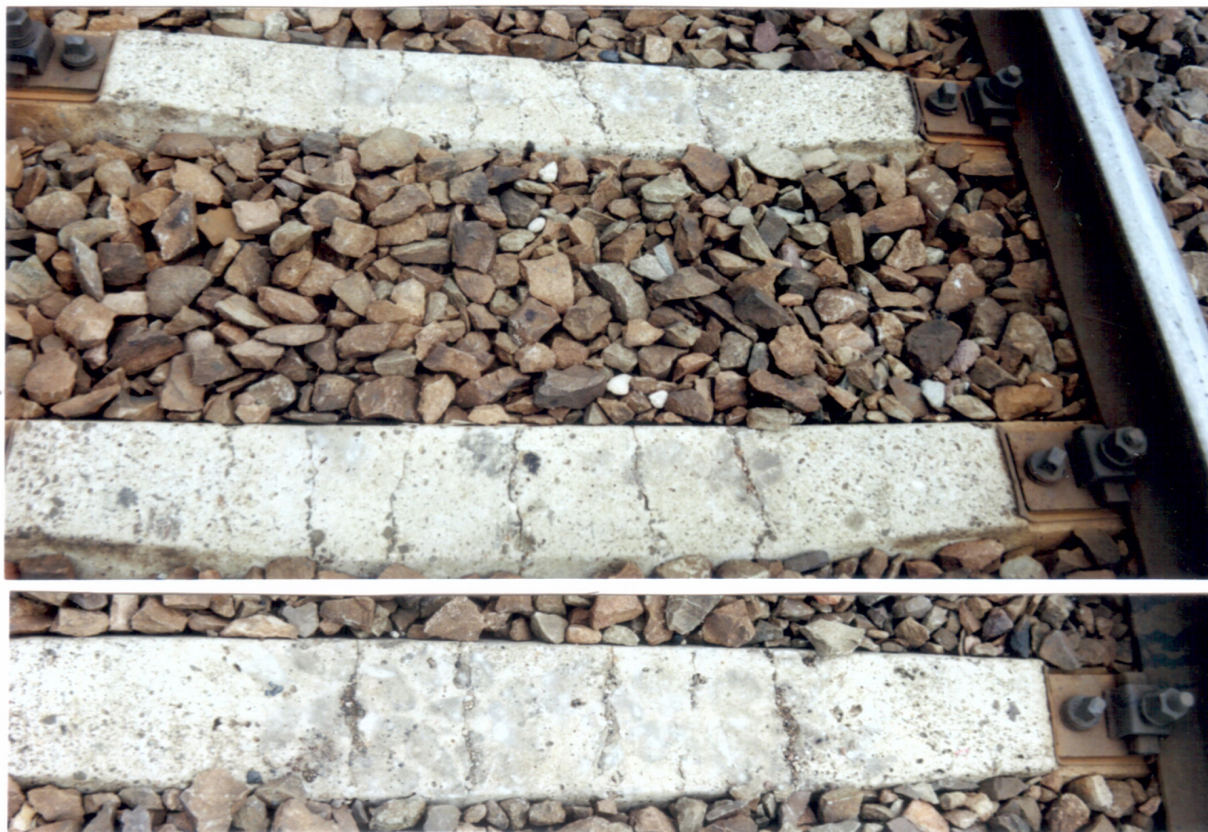
Рисунок 4 – Широко раскрытые трещины на верхней поверхности межрельсовых фрагментов шпал
