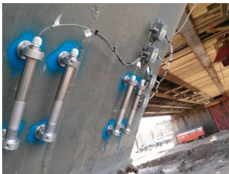
Рисунок 7 – Датчики ПЛП-2-П установленные на приварные шпильки
