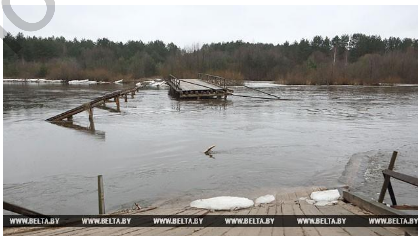
Рис. 3. Разрушенный деревянный мост на р. Неман
