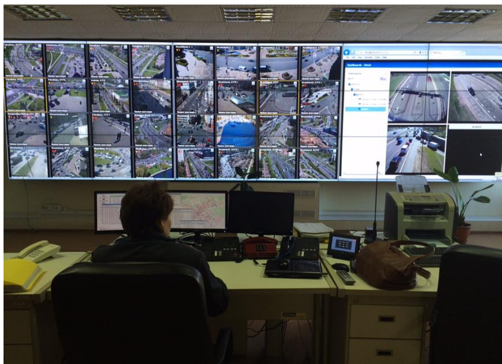
Рис. 7. Зал управления с системой видеонаблюдения
