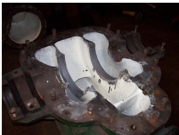
Рис. 1. Корпус насоса Д1250 с восстановленными мультиметаллом посадочными поверхностями под диффузорные кольца и защитным химически стойким композитным покрытием
