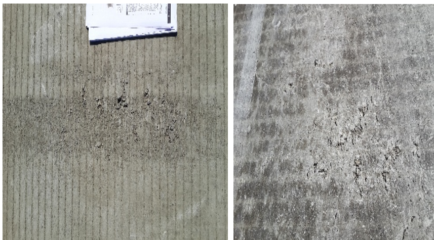
Рисунок 1. - Примеры дефектов цементобетонного покрытия
