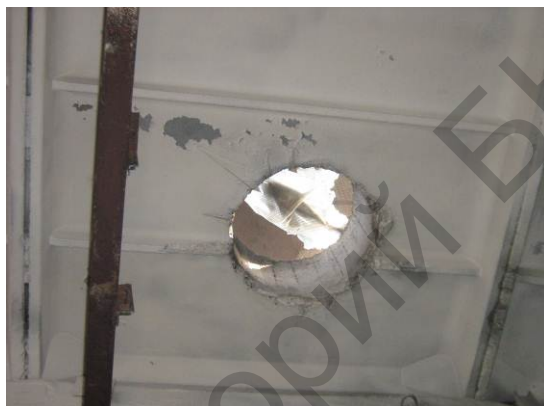
Рисунок 3. Следы протечек с кровли на плитах покрытия
