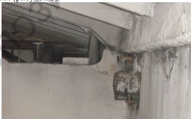
Рисунок 2. Трещины в бетоне опорного узла фермы
