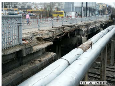
Рис. 2. Обрушение части пролетного строения путепровода
