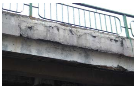
Рис. 2. Разрушение бетона карнизного блока и балки 1 в пролете № 2 путепровода на пересечении ул.Гинтовта и МКАД в г. Минске (апрель 2010 г.)
