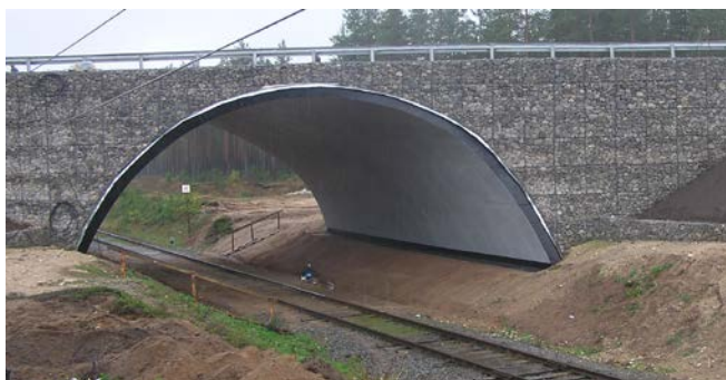
Рис. 1. Арочный грунтозасыпной мост в Вологодской области на 312 км а/д А-114 «Вологда - Новая Ладога».
