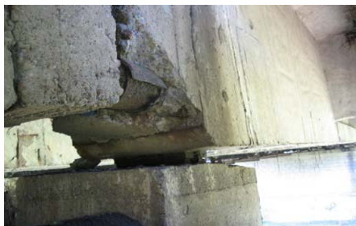
Рис. 1. Оголение и коррозия анкера преднапряженной арматуры балки № 6 на опоре № 7 моста через р. Днепр по просп. Пушкина в г. Могилеве (сентябрь 2009 г.)
