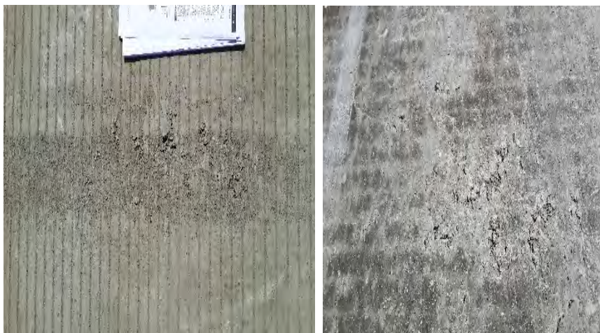
Рисунок 1. - Примеры дефектов цементобетонного покрытия
