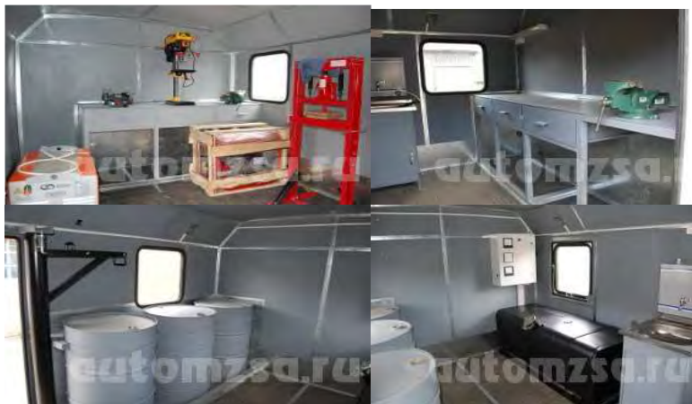
Рис. 3.17 Расположение оборудования в кузове-фургоне мастерской
