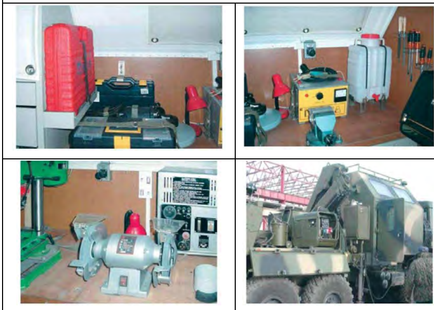
Рис. 3.11 Расположение основного оборудования в кузове-фургоне в РЭМ-К
