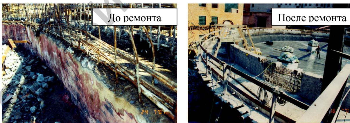
Рисунок 6 – Состояние железобетонных конструкций сгустителей на Солигорском калийном комбинате
