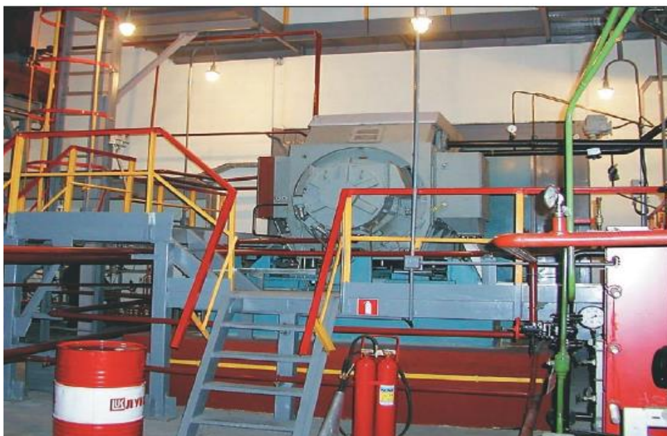
Рисунок 2 – Помещение генераторного отделения ДГУ на Гомельской ТЭЦ-2
