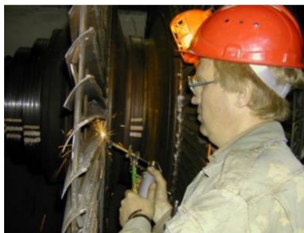
Рисунок 4 – Нанесение металлатором защитных покрытий на лопатки 30-й ступени при ремонте турбины ПТ-80-130/30 ЛМЗ АО «Кишиневская ТЭЦ-2» (ст. №1) при расположении ротора на козлах ремонтной площадки
