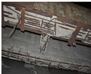
Коррозия рабочей арматуры рам эстакады
