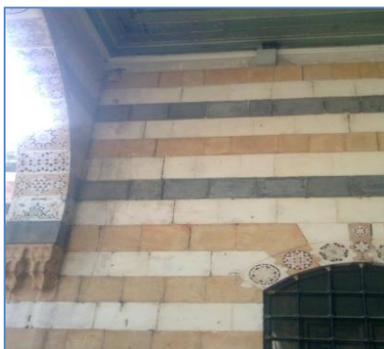
Рисунок 2. – Трещины во дворце Аль-Азем
