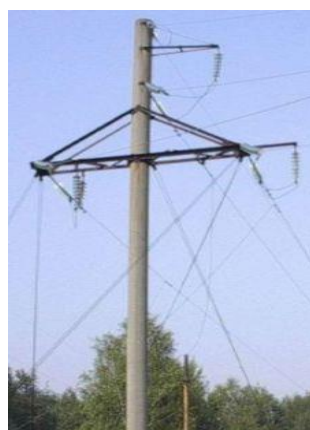
Рисунок 4. - Железобетонная опора 110кВ.
