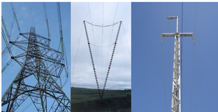
Рисунок 5. Металлические опоры воздушных линий
