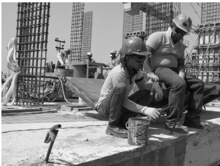
Рис. П4.15. Процедура инъецирования. Рабочий следит за консистенцией вытекающего через штуцер раствора
