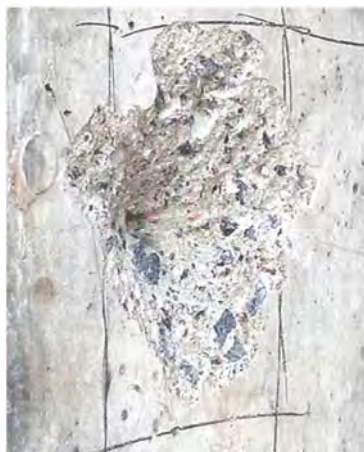
Рис. 1.5. Лунка в бетоне после отрыва анкера
