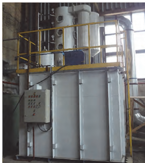
Рис. 8. АБХУ очистки вентвоздуха от триэтиламина на АО «Копейский машиностроительный завод»
