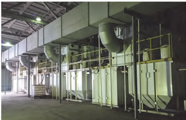
Рис. 5. Газоочистной комплекс из четырех АБХУ общей производительностью по вентвоздуху 100 000 м 3 /ч
