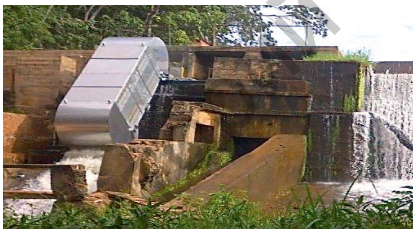
Рисунок 7 – Гидроагрегат мощностью 12 кВт, расходом 400л/с, напор 3,5 м
