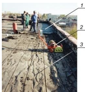
Рис. 1. Механическая разборка кровли с устройством битумной мастичной изоляции (а.с. СССР 1742420, пат. ВУ 9778):
