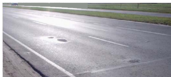
Рис. 2. Разрушение покрытия за счет появления белых пятен
