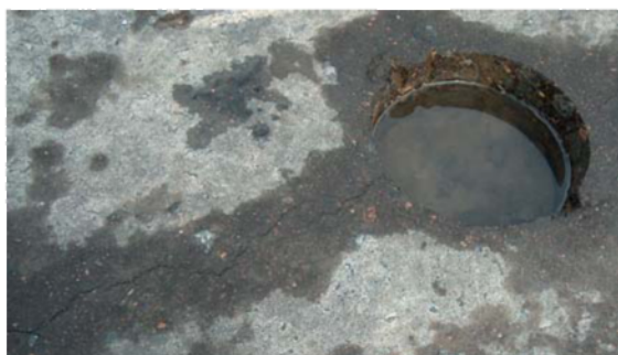
Рис. 3. Заполнение керна водой в местах развития коррозионных деформаций
