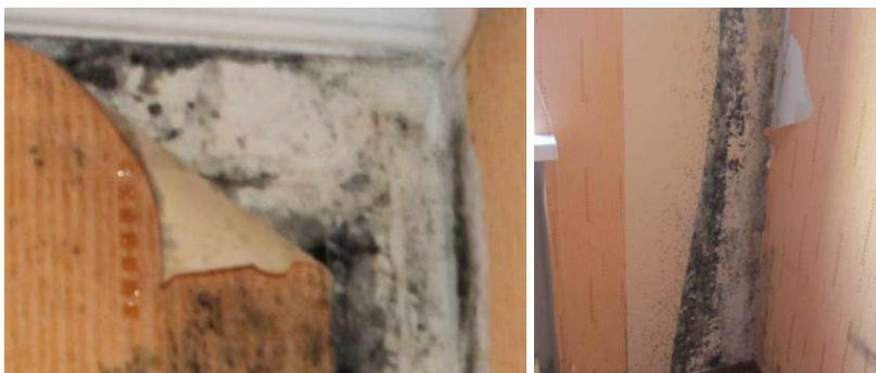
Рис. 1. Характерные случаи появления биологической коррозии (грибка) на внутренней поверхности стен жилых зданий
