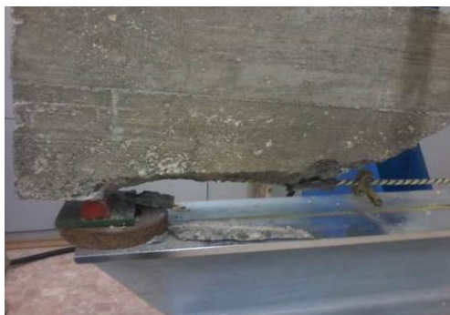
Рис. 7. Опытный образец после разрушения в результате скола защитного слоя бетона
