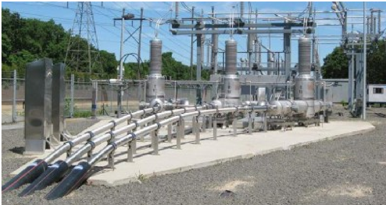
Рисунок 5 – ВТСП-кабель 138 кВ (2400 А) длиной 660 м
