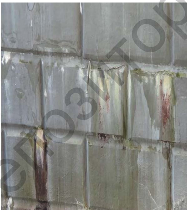
Рисунок 5 – Выщелачивание и подтеки на низовом открьлке правобережного устоя
