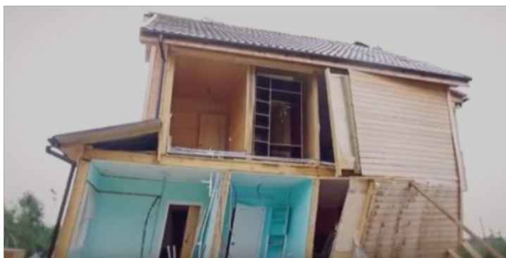
Рис. 1. Разрушение щитового дома из-за ветровых воздействий
