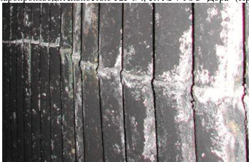
Рисунок 3 – Массовый прогиб экранных труб газоплотной панели в зоне монтажных стыков
