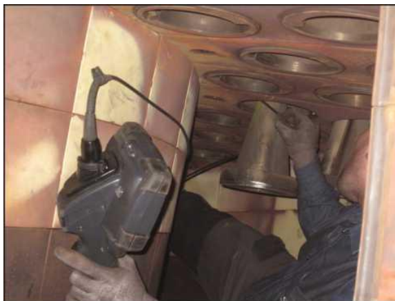
Рисунок 3 – Осмотр бороскопом горелочной камеры ГТУ Alstom GT13E2 МТЭЦ-3
