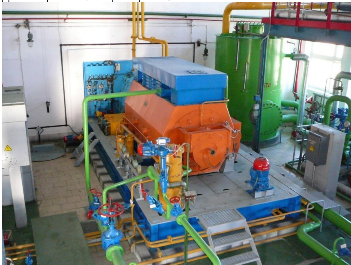
Рисунок 2 – Общий вид на детандер-генераторную, установку 5000 кВт (ДГУЭ-5000)
