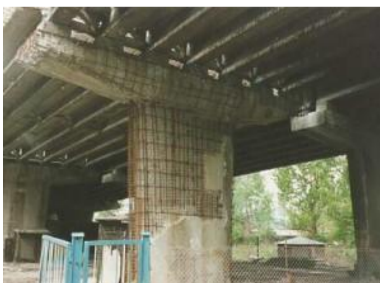
Рисунок 3 – Внешние признаки коррозии арматуры в бетоне
