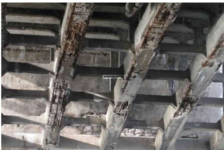
Рисунок 1 – Коррозия арматуры и разрушение бетона
