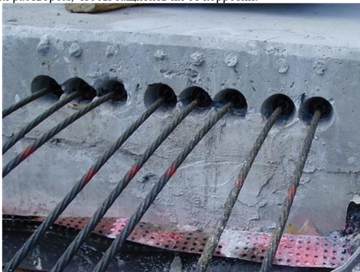
Рисунок 7. Выпуски арматурных канатов после натяжения. Канаты натягивают с усилием 230кН, что приводит к удлинению 20см в кабеле длиной 30,5м [6]
