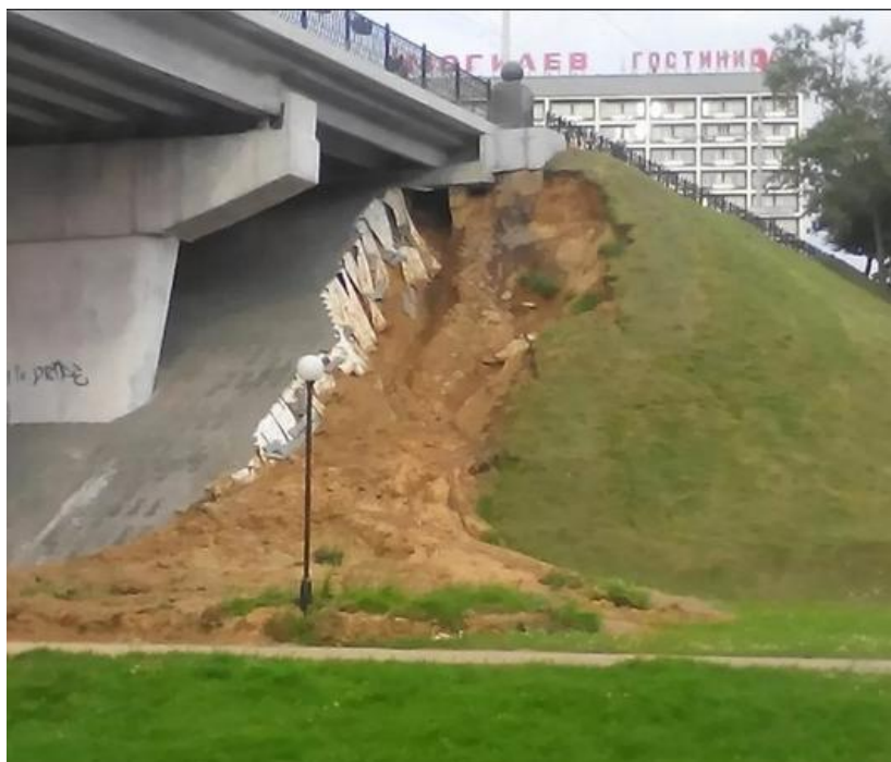
Рисунок 1 – Промоина на конусе насыпи у моста через р. Дубровенка
