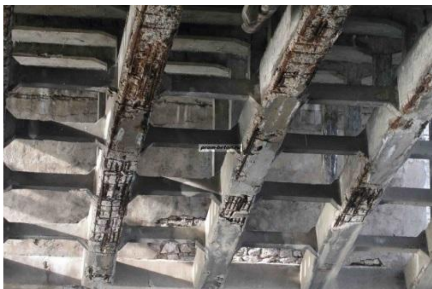
Рисунок 1 – Коррозия арматуры и разрушение бетона
