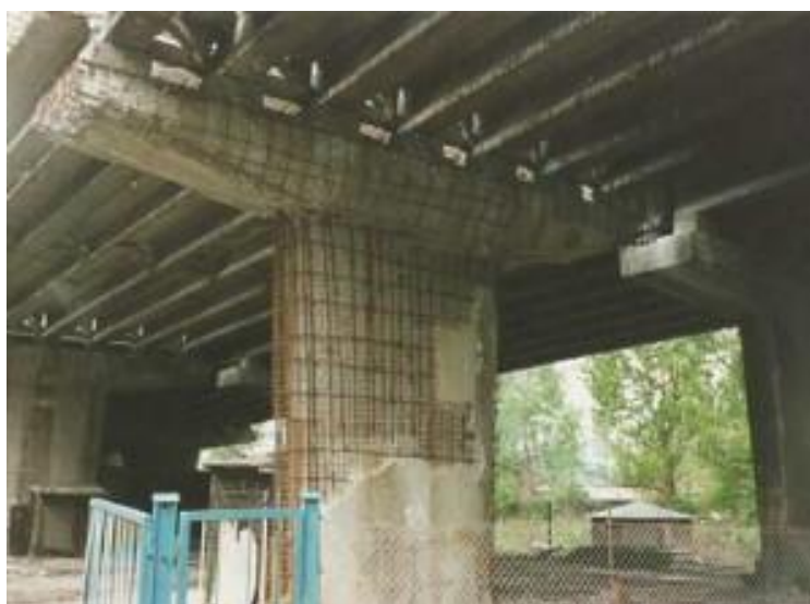
Рисунок 3 – Внешние признаки коррозии арматуры в бетоне
