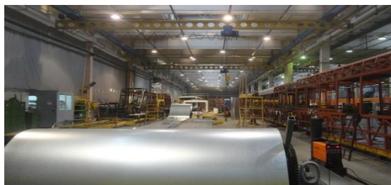
Рисунок 7 – Крановое оборудование, установленное в цеху предприятия ОАО «Управляющая компания холдинга «Белкомунмаш»
