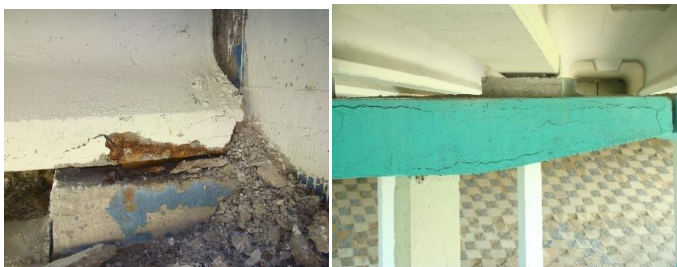
Рисунок 1. Разрушение подферменников и балки пролетного строения, образование трещин в ригеле опоры
