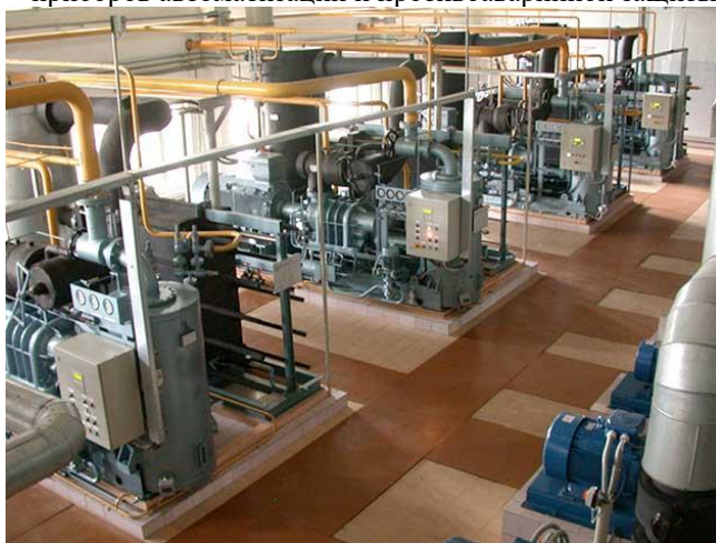
Рисунок1 :Помещение компрессорной аммиачной холодильной установки.
